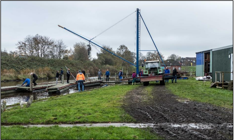
Leichter Flurschaden beim Brückenslippen.
